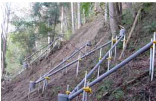
斜面の崩落監視用光ファイバーセンサーの例
